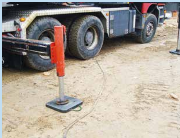
Forkert: Kabler beskadiges når de ligger på køreveje
