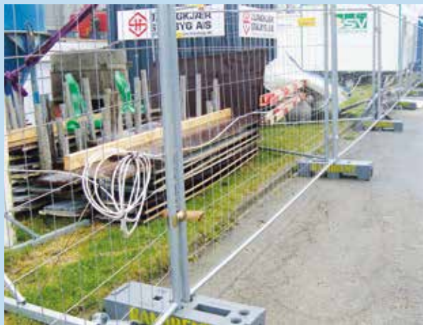
Korrekt: Kabler er korrekt hængt op
